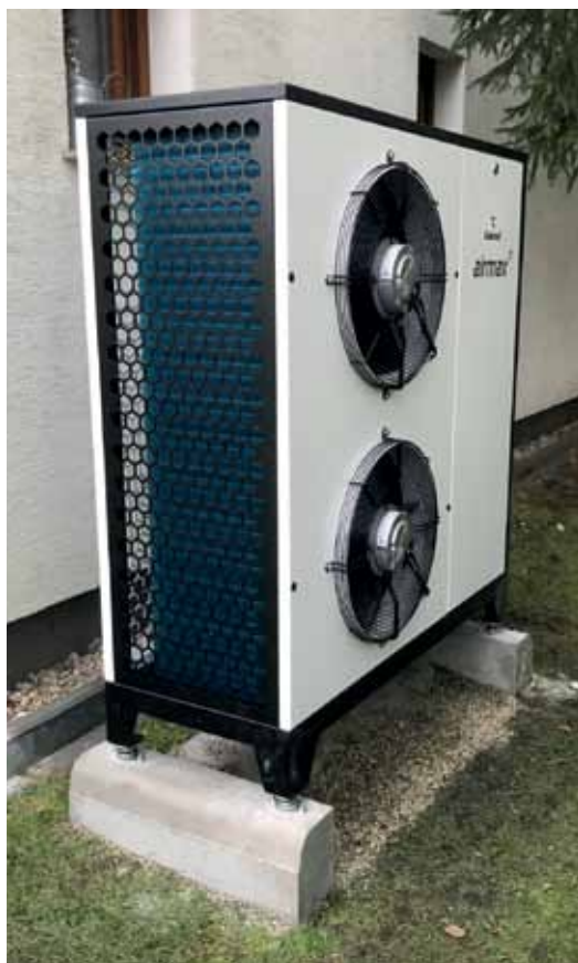
Pompa ciepła zabezpieczona za pomocą wibroizolatorów sprężynowych
