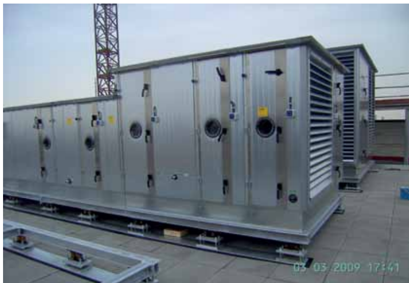
Centrala wentylacyjna zlokalizowana na dachu zabezpieczona za pomocą wibroizolatorów przed przenoszeniem drgań na konstrukcję budynku
